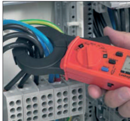
Differenzstrommessung mit Leckstromzange
